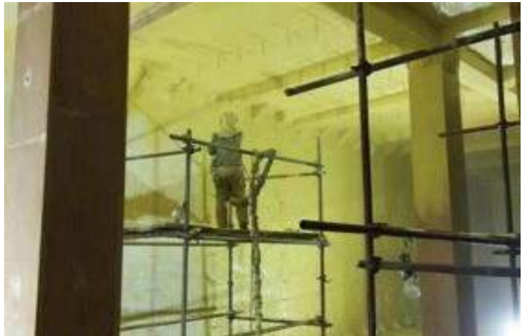
冷库保温层外表防护
