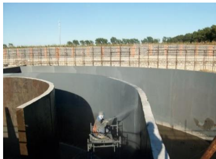
中科炼化污水池
